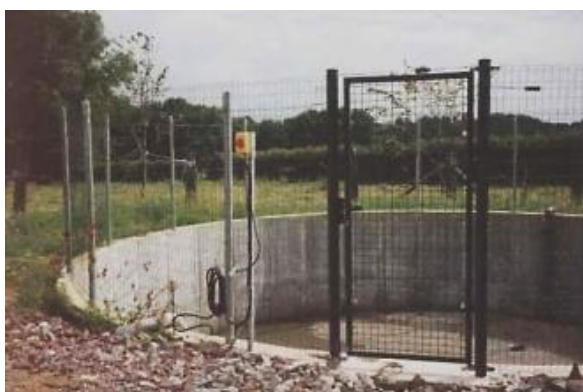
Cuve de stockage des effluents d'élevage pour lutter contre les pollutions ponctuelles
