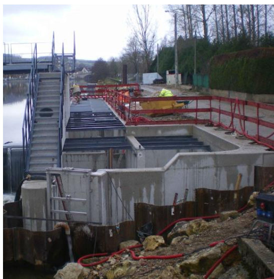
Photo 16 : Construction d'une passe à poisson d'assez grande dimension sur l'Yonne à Villeneuve-sur-Yonne (© Onema).
